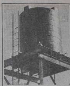
Der neue 8000 Liter Wassertank ist im Likoni Projekt bereits installiert worden.
