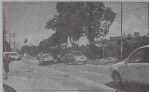
NACHHER: Das zweite Bild wurde nur zwei Tage nach dem ersten aufgenommen. Die Stadtverwaltung hat sofort reagiert und den Schaden behoben. Aber bei dem ständigen Regenschneit es eine Sisyphusarbeit zu sein, denn es entstehen schon wieder Löcher.
